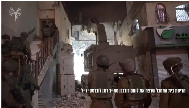
عملية هدم منزل الإرهابي إسلام أبو حميد في مخيم الأمعري برام الله (حساب الناطق بلسان الجيش الإسرائيلي على التويتر، 24 تشرين الأول / أكتوبر 2019)
