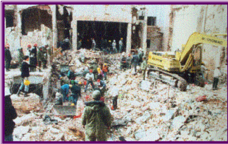
Les ruines du bâtiment de l'AMIA
