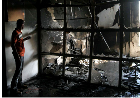
Dégâts causés à l'École Américaine Internationale de Gaza (Agence de presse Ma'an, 6 avril 2008).
