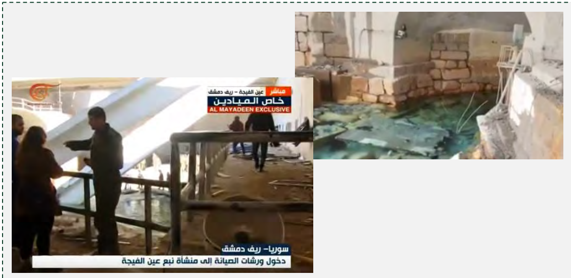
Справа: повреждения, нанесенные одному из сооружений у источника Эйн Аль Фиджа (аккаунт YouTube الشعب ينتصر декабря 2016 г., сирийское телевидение, 29 января 2017 г.). Слева: ремонтная бригада на входе в сооружения у источника Эйн Аль Фиджа (телеканал "Аль Миадин", 30 января 2017 г.)
