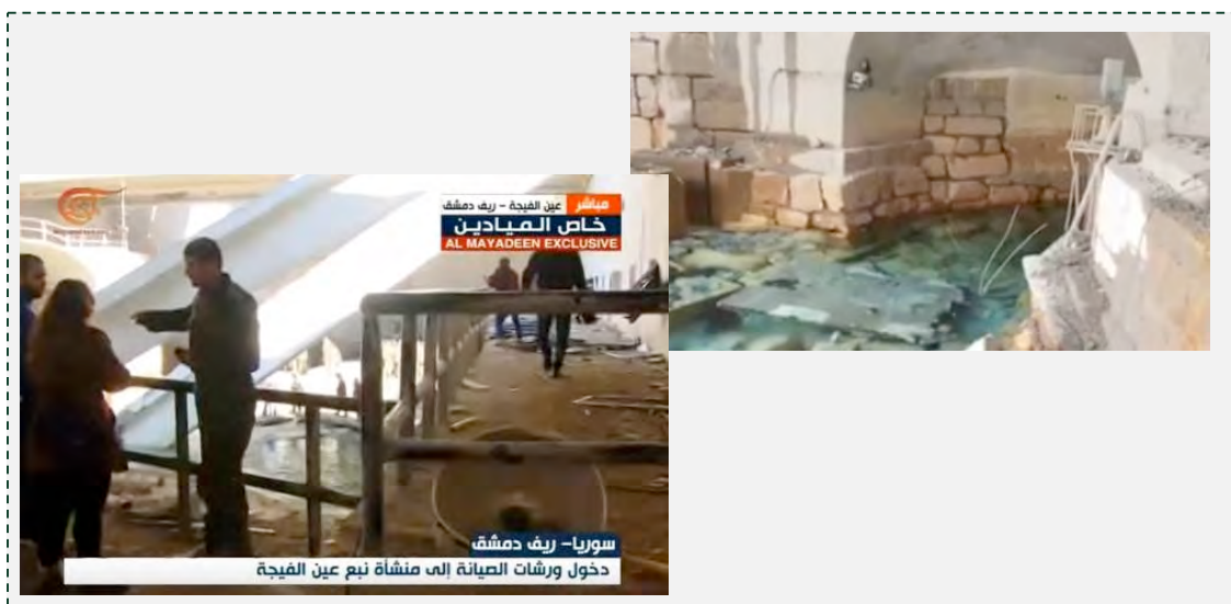
Droite : Dégâts causés au bâtiment abritant la source d'Ain al-Fijah (YouTube, 27 décembre 2016 ; télévision syrienne, 29 janvier 2017). Gauche : Les équipes de maintenance entrent dans le bâtiment abritant la source d'Ain al-Fijah (Al-Mayadeen, 30 janvier 2017)
