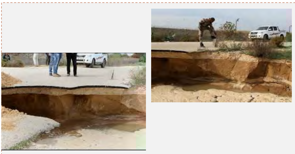
Effondrement d'une route à la frontière entre la bande de Gaza et l'Egypte à Rafah, causé par les inondations de la région des tunnels par l'armée égyptienne (Page Facebook PALDF, 25 novembre 2015)
