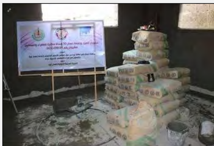
Projet de reconstruction de 50 unités de logement dans la bande de Gaza, financé par les Sultanats d'Oman et la Banque islamique de développement à Djeddah (Page Facebook Paldf, 3 mai 2015)
