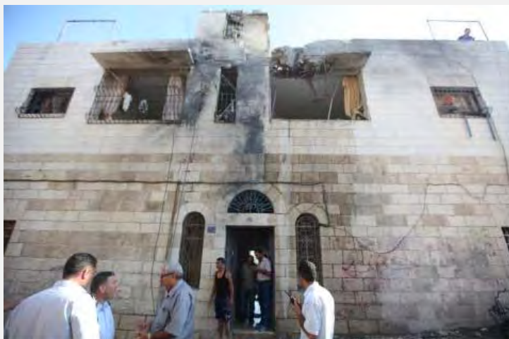
Поврежденный жилой дом в деревне Бейт Сахур, возле Вифлеема ("Аль Кудс", 4 августа 2014 г.)
