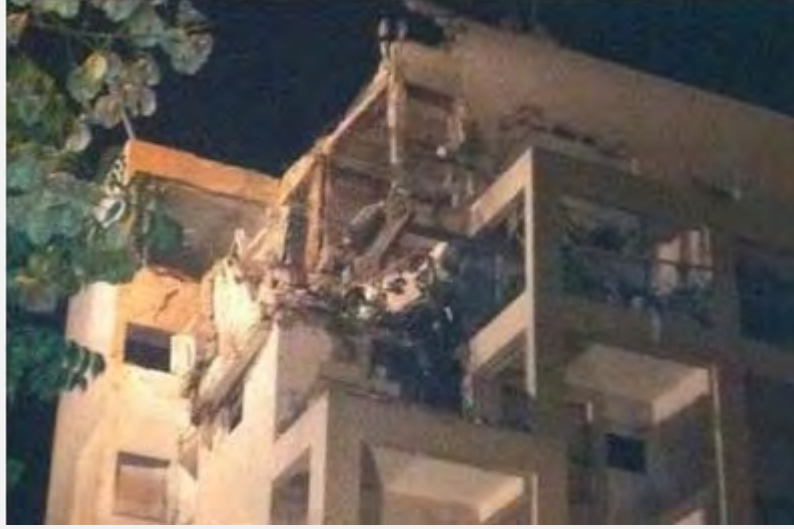
إلحاق أضرار جسيمة في مبنى سكني في ريشون لتسيون نتيجة إصابة صاروخ فجر 5 (صفحة فيسبوك لشرطة إسرائيل، 20 تشرين الثاني 2012)
