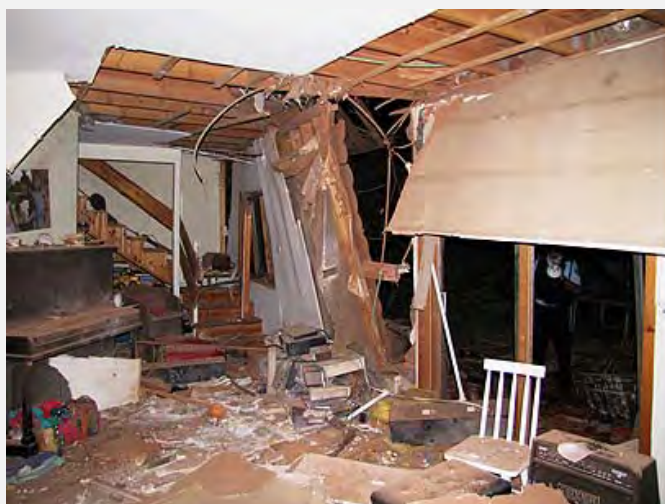
خرابی وارده به خانه در شورای منطقه ای بئرطوبیا (سخنگویان شورای منطقه ای بئرطوبیا، هجدهم نوامبر 2012).
