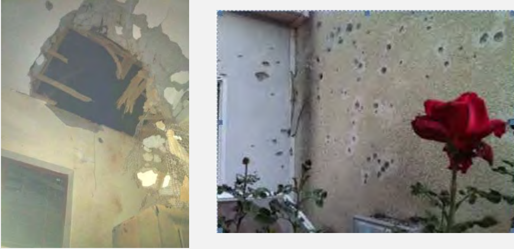
أضرار تلحق بمنازل نتيجة إصابات الصواريخ (Daniel Hagbi/Sderot Media Center, 12 تشرين الثاني/نوفمبر 2012)
