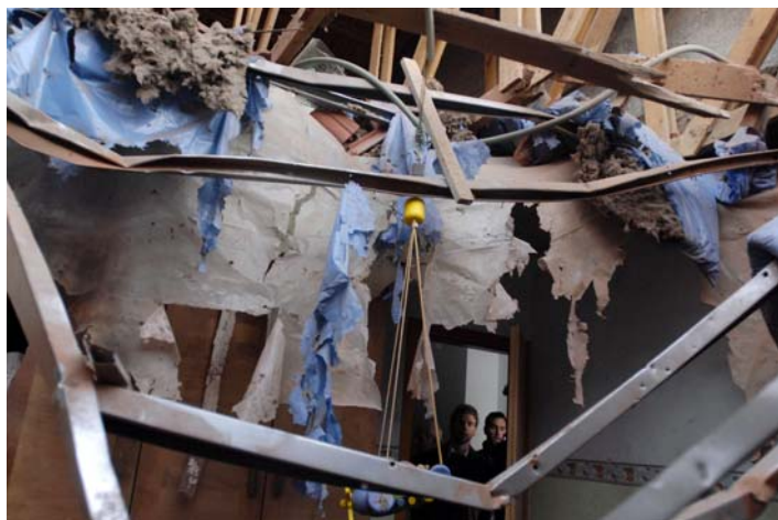
Maison de Sderot endommagée par un tir de roquettes Qassam (Amir Cohen, Reuters, 15 janvier 2008)
